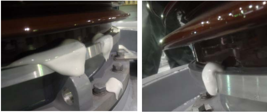
图 8 RIP a、b 相套管法兰处内部填充绝缘膏体泄漏
