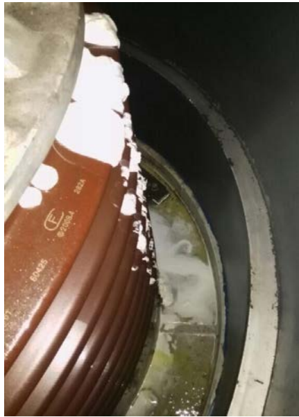
图 9 RIP b 相套管头部内部填充绝缘膏体泄漏
